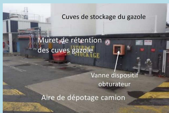
Figure 64. Aire de dépotage camion et rétention du stockage de gazole
